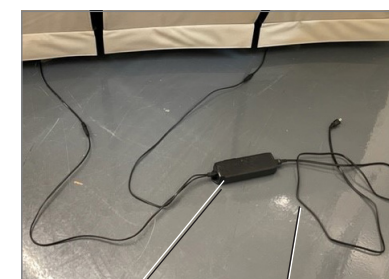
Transformateur électrique Cordon électrique de 120 volts
